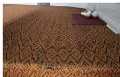
Foto 4: Durchgetretene Podesttrittkante bei vollflächiger Verklebung
